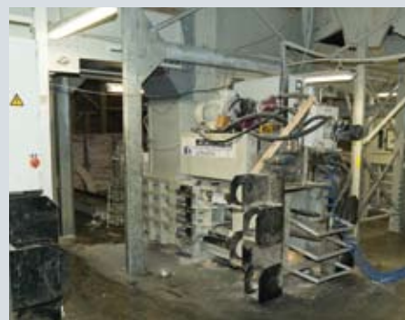
Бумажные отходы утилизируются современной системой аспирации
